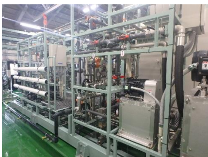
▼脱塩処理装置
