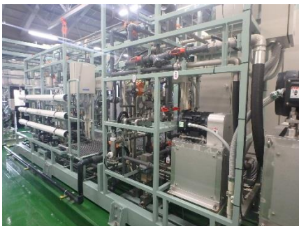
▼脱塩処理装置
