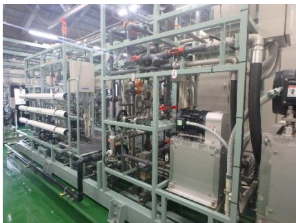
▼脱塩処理装置
