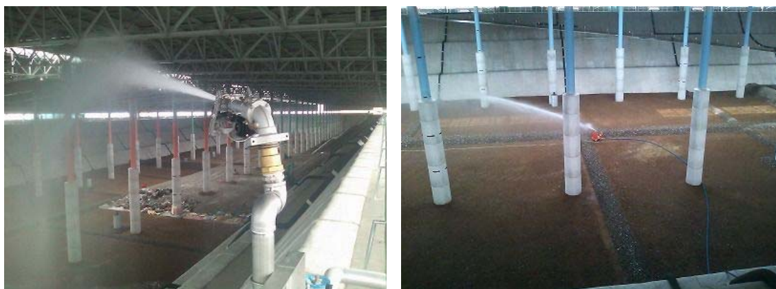
図10-1-2 散水設備事例（その2：十勝環境複合事務組合の事例）
