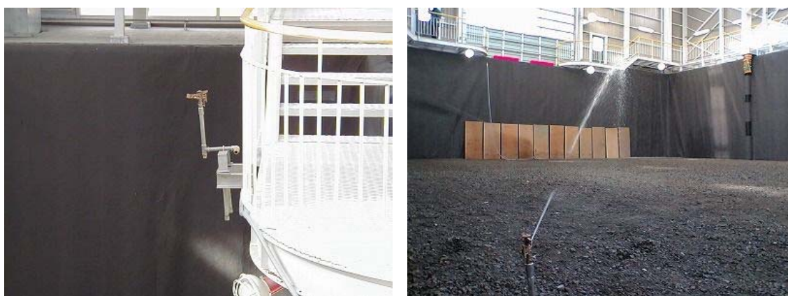
図10-1-1 散水設備事例（その1：山形村の事例）
